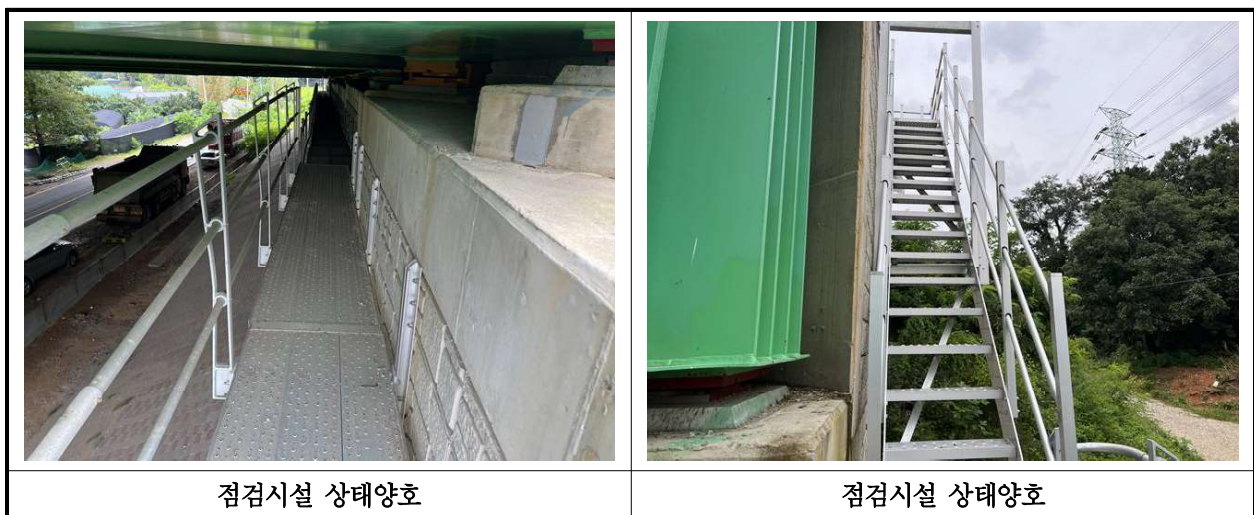
【사진 26.3.24】 교량 점검시설 손상현황
