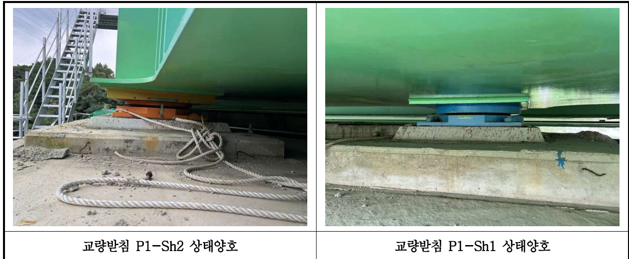
【사진 26.3.11】 교량받침 손상현황
